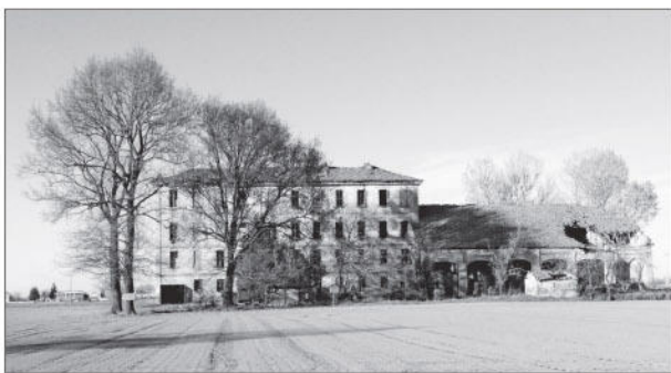
Cascina Cerro edificata a vari piani con lo scopo preciso di crearvi un notevole allevamento di bachi da seta. Era circondata da centinaia di gelsi. Ora è in totale fase di degrado.
