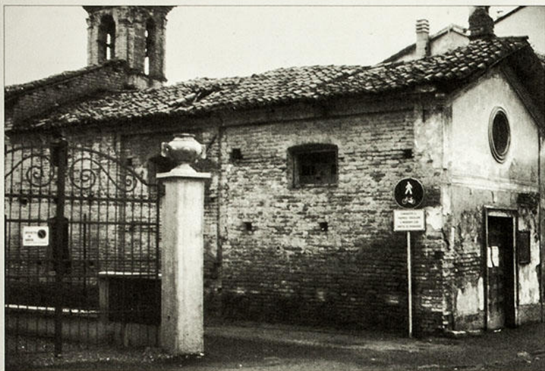
Autunno 1996. Il tetto comincia a cedere e avvengono i primi crolli di coppi sulla volta. Il Comune ha deciso di colmare la roggia e di trasformarla in un percorso ciclabile.
